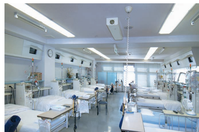
■小野内科医院 処置室の設置例
